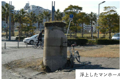
浮上したマンホール
