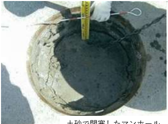
土砂で閉塞したマンホール
