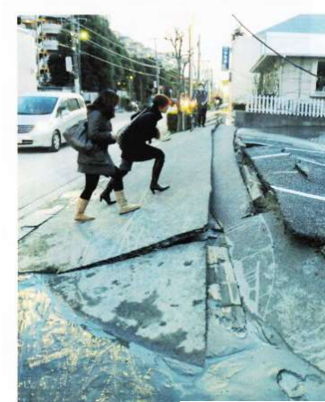
液状化で損傷した歩道
