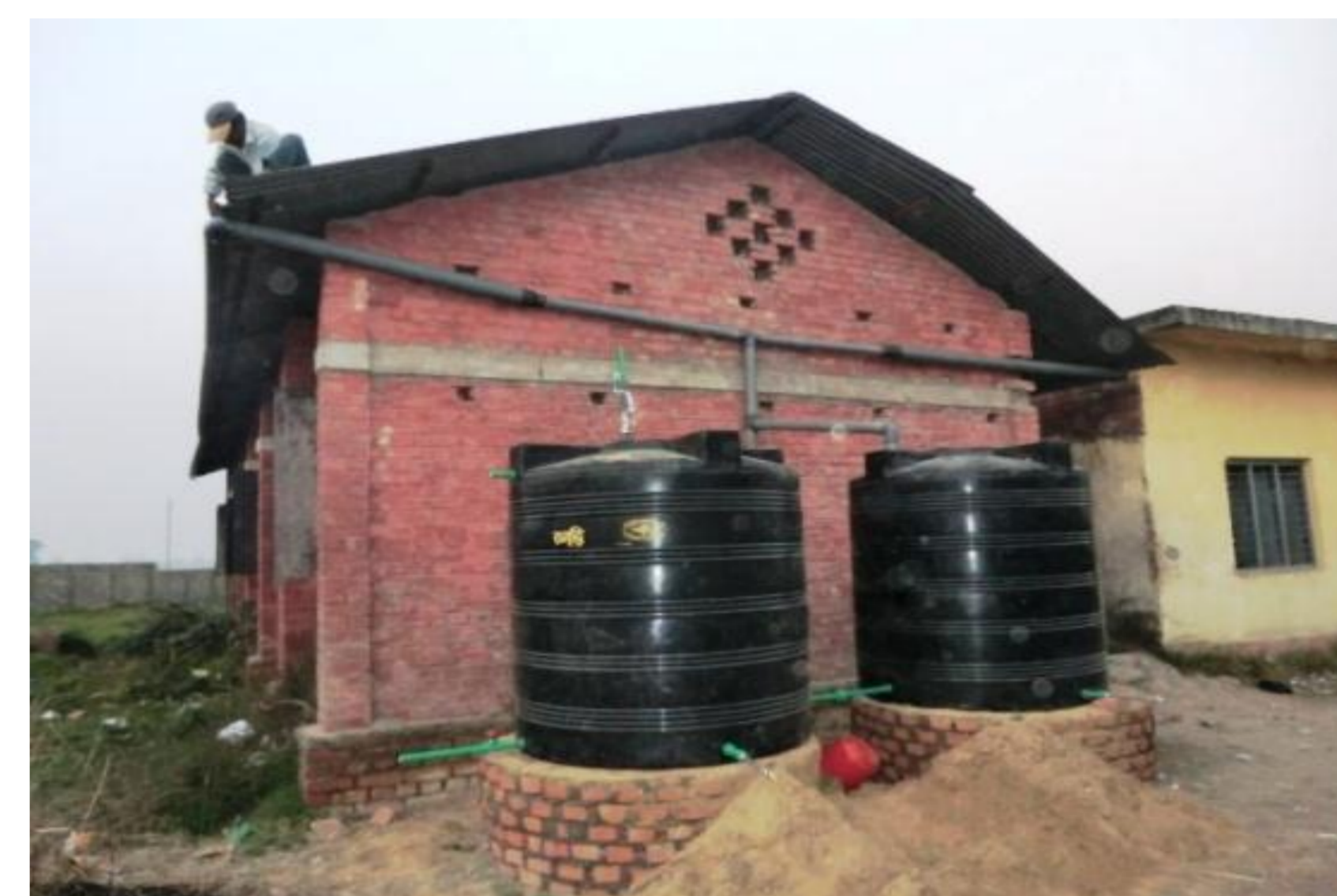
写真4. 小学校の校舎に設置された雨水利用装置
